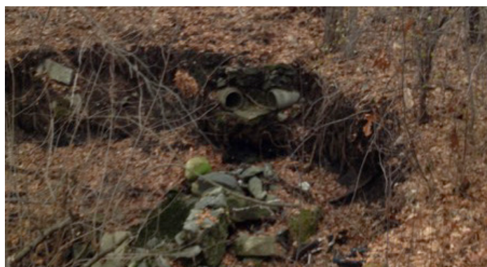
Imagem dos canos de drenagem antiga de 2014.
